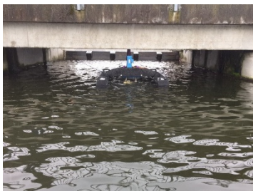
OLOID Typ 400 mit Strömungsrichtung zur Wehrklappe
